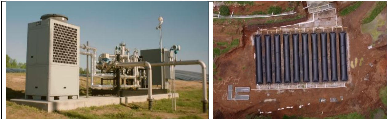
Sistema de biodigestores encadenados en Carolina del Norte y abajo a la derecha en México para 300 cerdas
